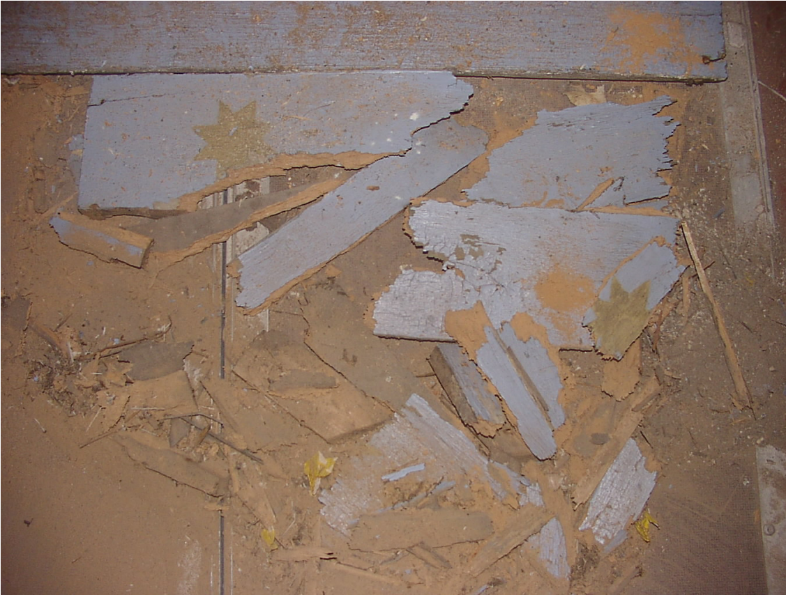
So geschädigt waren einige der Bretter (30. September 2003; Foto: Julius )
